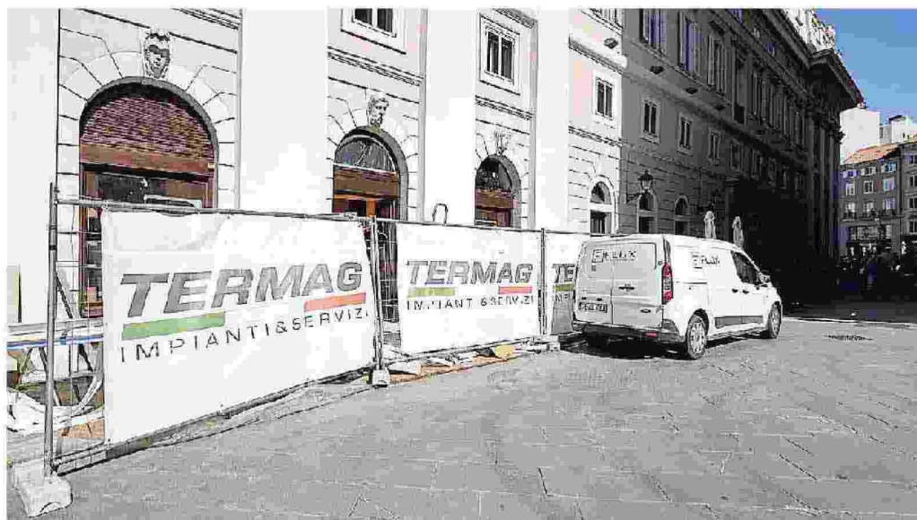
Il cantiere in piazza Verdi e, in alto, i lavori in corso all'interno del punto vendita. Massimo Silvano
